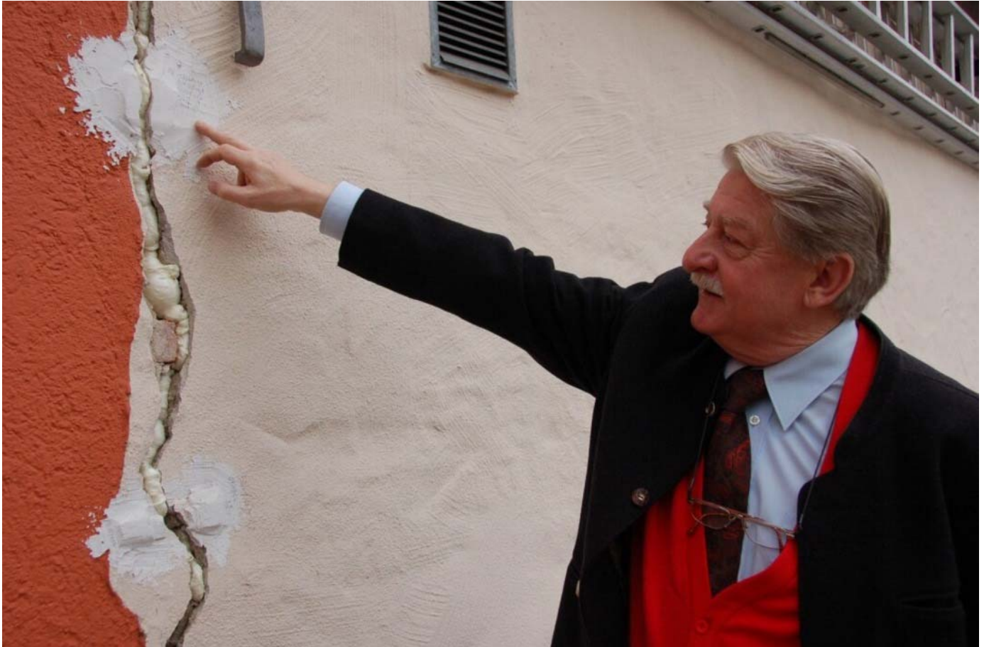
Nur noch Flickwerk: Wolfgang Trch 2008 vor dem Spalt an seinem Haus. Foto: Silke Kohlmann
